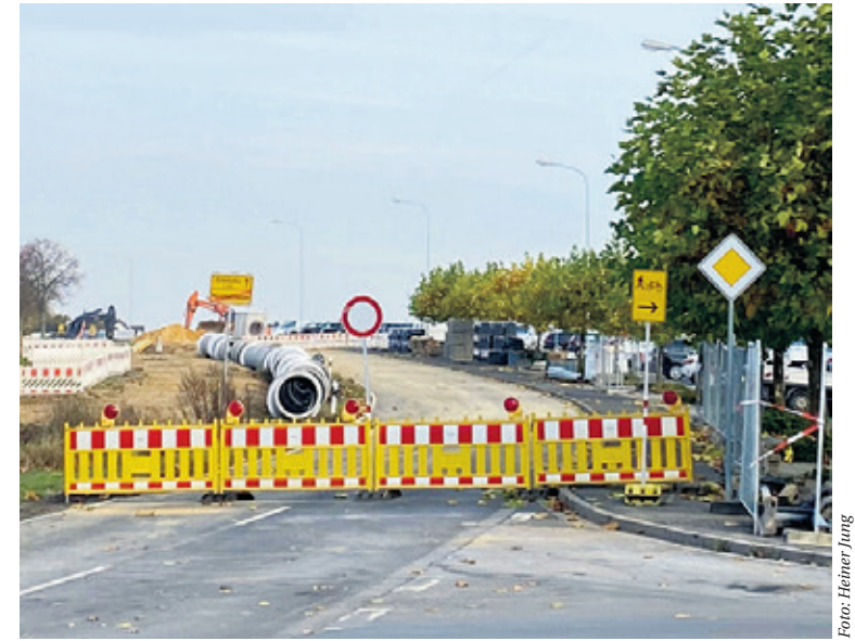
Die Sperrung der Landstraße ist leider unumgänglich. Dank der guten Baustellenorganisation wird sie aber vom 17. Dezember bis 16. Januar vorübergehend freigegeben
